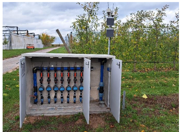
Bild 1: Eine von 20 Verteilerboxen mit je acht ansteuerbaren Bewässerungssträngen.
